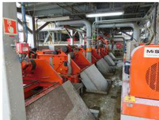
泥浆处理系统
